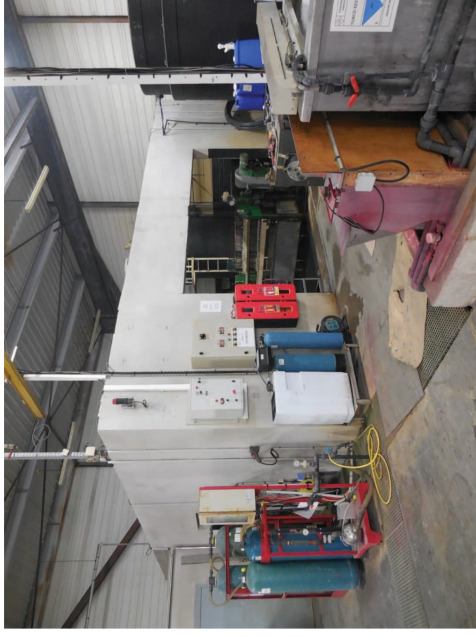
Photo 10 : Station de traitement physico-chimique interne
